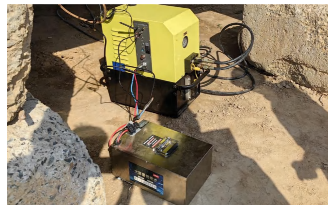
图5-2 (b) 现场一体式油泵及电池连接图
