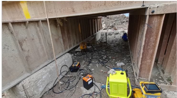
图5-2(b) 现场油泵及千斤顶连接图
