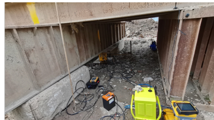
图5-2(b) 现场油泵及千斤顶连接图
