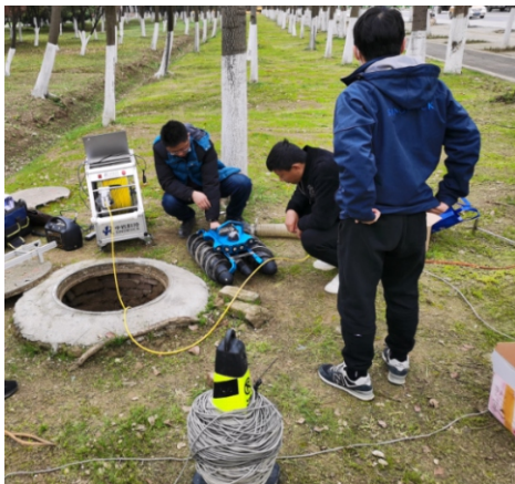
现场系统工程测试
